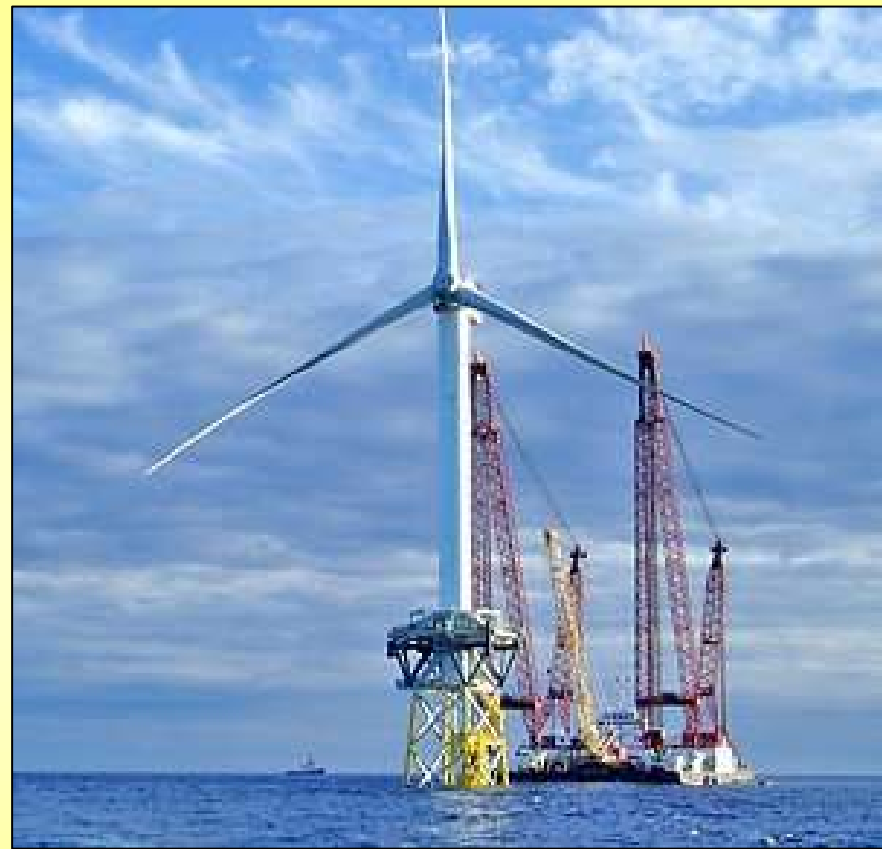
REPOWER 5MW: Potenza nominale 5 Mw, Diametro rotore 126m
